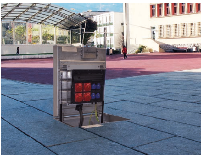
Unterflurverteiler mit Klappdeckel
