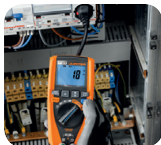
Impedanzmessung ohne RCD-Auslösung
