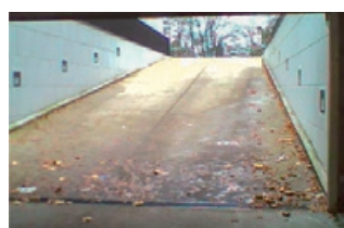
Tiefgarageneinfahrt mit Rampenheizung
