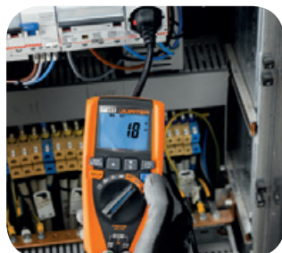
Impedanzmessung ohne RCD-Auslösung.
